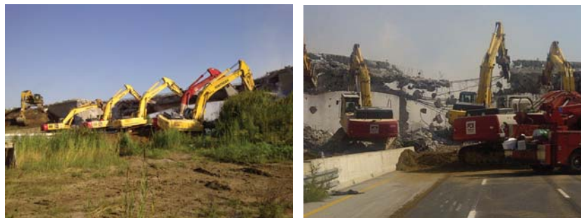
Les équipes Parkway travaillent pour enlever le pont North Talbot Road situé au-dessus de l'autoroute 401.
